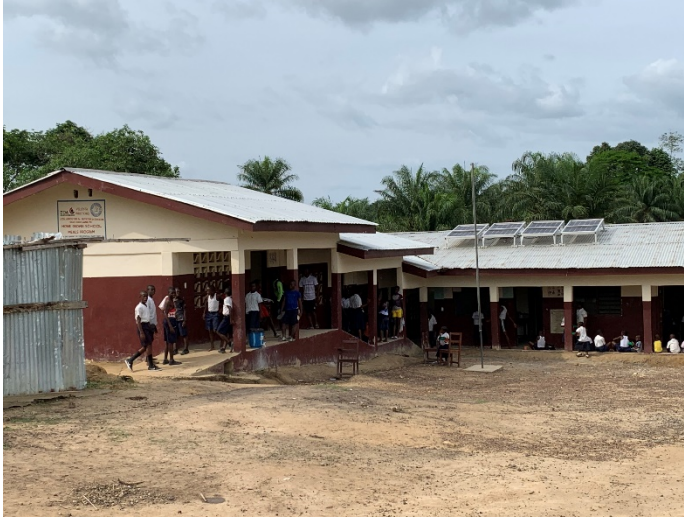
Solcellepanel er montert og tatt i bruk
